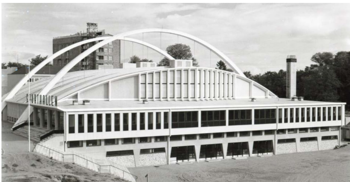
Sporthallen under uppbyggnad 1955. I bakgrunden pågår arbetet med Dalkullan 24 och bebyggelsen på Dalkullan 25 är precis färdigställd.
