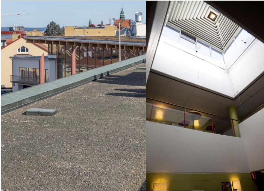
Bild. Till vänster. Landsstatshusets platta tak med kopparsarg. Till höger. Ett av ljusschakten med taklanternin. I bilden syns även den konstnärligt uppförda ljudabsorbenten samt de ursprungliga räckena som finns i ljusschakten.
