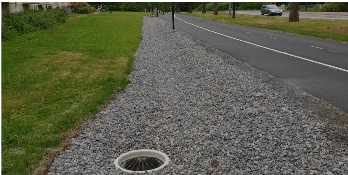
Figur 3. Exempelbild på ett makadamdike utmed en cykelväg. Foto: Dämningsverket 2018.
