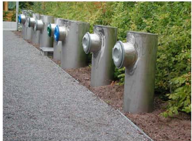
Nedkastningsluckor för sopsug, Hammarby Sjöstad
