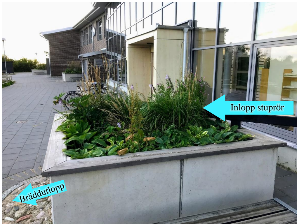
Figur 33. Upphöjd växtbädd med inkommande vatten från stuprör och bräddutlopp över mark.
