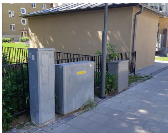
Obehandlade el- och teknikskåp innerstaden (gestaltungs-nivå 2).
