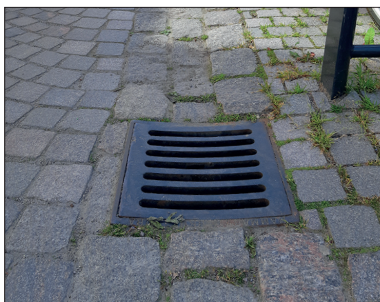
Dagvattenbrunn i anslutning till rännal.
